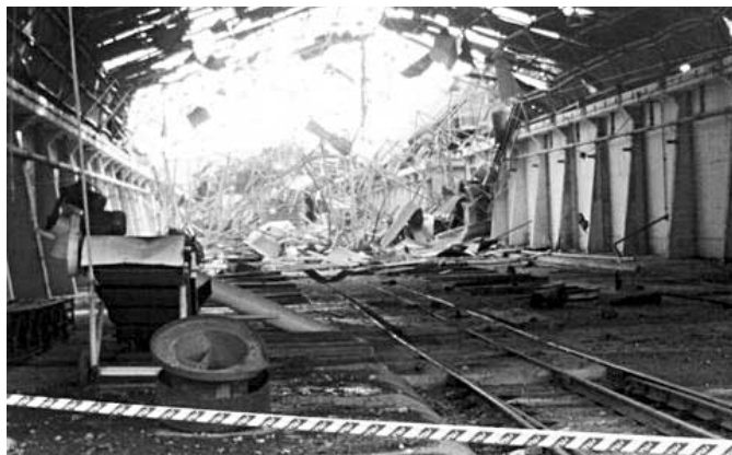
Explosión y silos: El 26 de abril de 2002, el polvo en suspensión de cereales desencadenó explosiones sucesivas en los silos que la Asociación de Cooperativas Argentinas tiene en el centro geográfico de la ciudad de San Lorenzo, Santa Fe.
